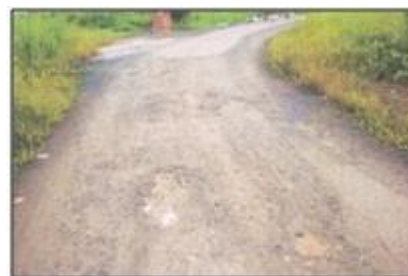
Jalan Terlupas Ada Lubang Jalan Pemurus Dalam Kelurahan Pemurus Kota Banjarmasin ( Tampak Sebagian Lapis Aspal Permukaan Terkoyak/Terkelupas Lebih 50% ada Lobang Akibat Tekanan Ban )
