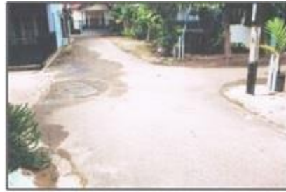
Permukaan Jalan Terkelupas Jalan Gerilya Kelurahan Kelayan Dalam Kecamatan Banjarmasin Utara ( Tampak Lapis Aspal Permukaan Terkoyak, Retak Pendek dan Terjadi Penurunan \pm 6 cm )
