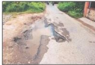
Retak, Ambles dan Berlubang Jalan Simpang Kantor Kelurahan Pelabuhan Raya Kecamatan Banjarmasin Timur ( Tampak Retak Memanjang ada Ambles dan Berlobang )
